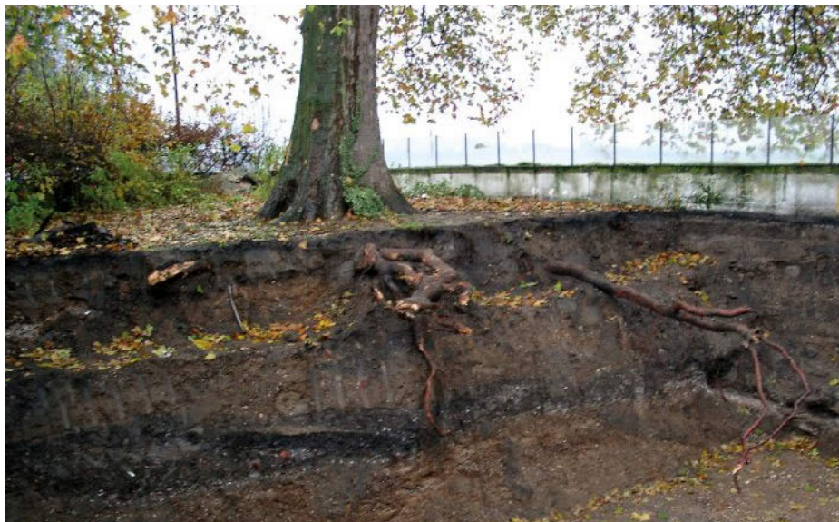
// Situation 2002: Die Baugrube verlief bis etwa 30 Zentimeter an den Platanenstamm heran, vier Starkwurzeln lagen frei. //
